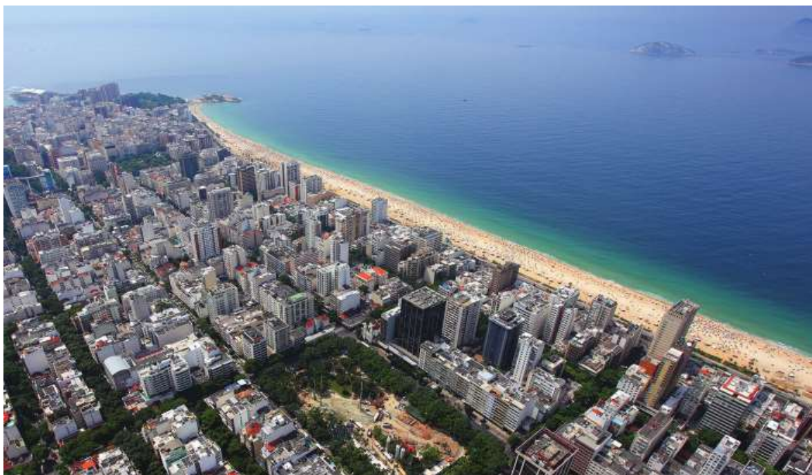
Figura 37: Fotografia aérea com Praça Nossa Senhora da Paz ocupada pelo canteiro de obras
